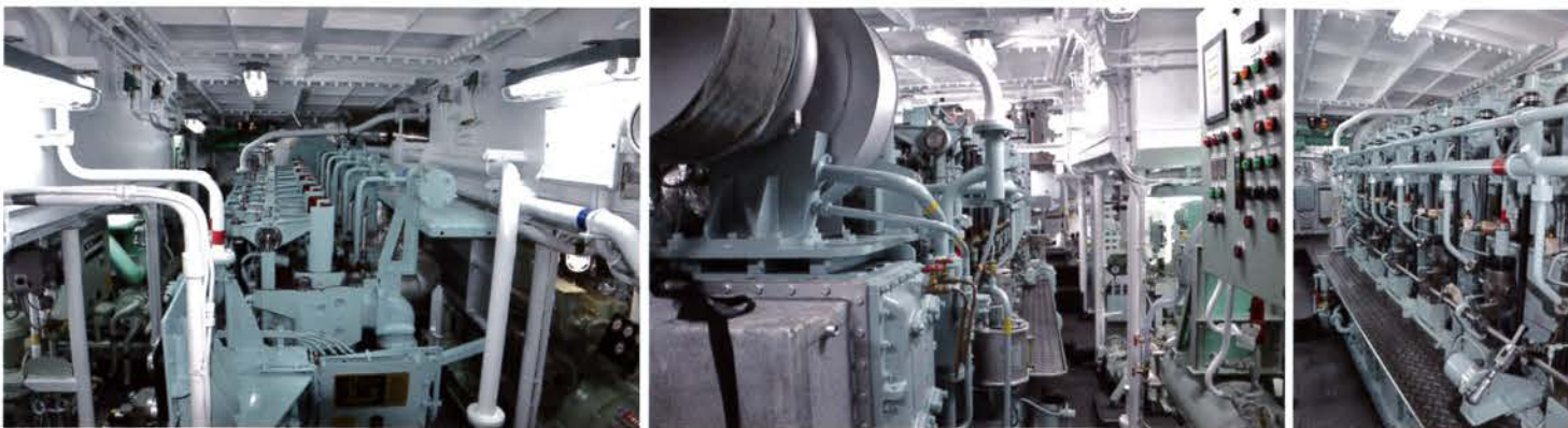
▲大型主機関が搭載された機関室内部
